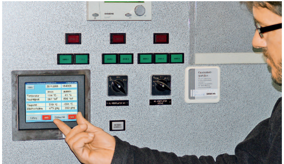
Die Zentraleinheit im Schaltschrank Zivilschutzanlage Steinmättli Stans.
